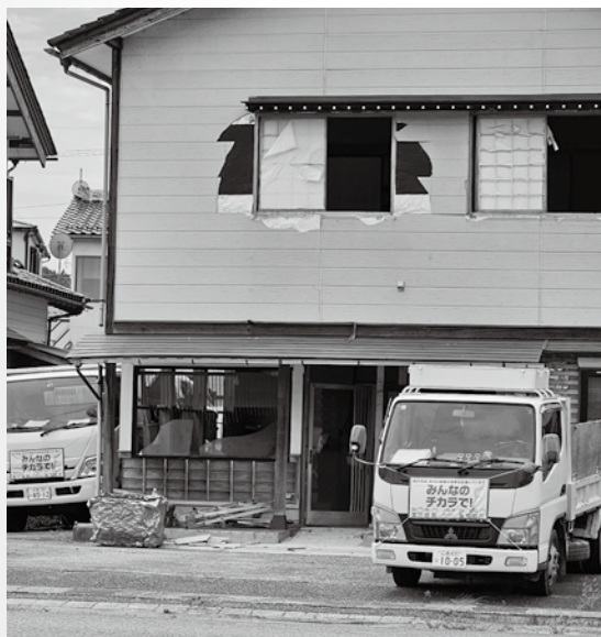
半壊した穴水町の店舗
