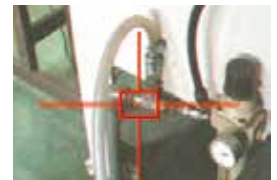
圧空漏れ箇所表示 超音波検出圧空漏れチェッカー使用 (漏れ箇所画像表示)
