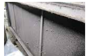
フィルタの汚れ箇所 フィルタが汚れ、吸気圧で暖房機のフィルタが歪んだ状態
