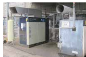
コンプレッサ排気 空気圧縮熱で加熱された排気を冬季は工場内に導き、暖房の補助とすることができる。
