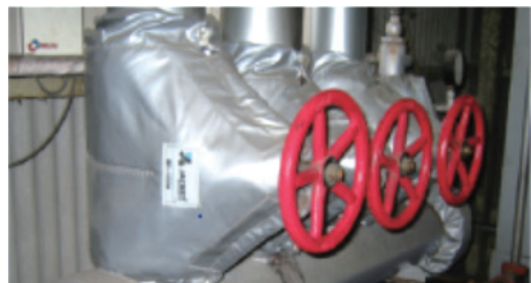
保温カバーを取り付 蒸気バルブ
